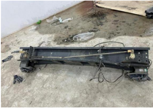
图 9 事故电梯安全钳破坏情况
