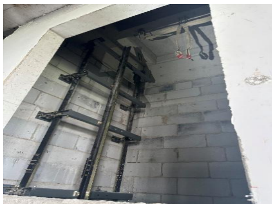
图1 事故电梯井道图
